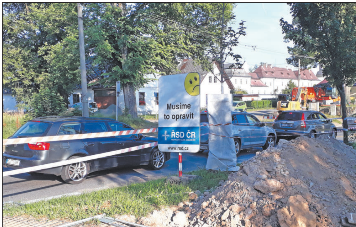
LETOŠNÍ léto ve Žďáře, to jsou kolony. Oprava průtahové silnice je již u zámku, provází ji i rozkopaná kanalizace.
