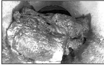
ZÁBĚR na propadlé kanály z podzemní kamery. Foto: archiv
