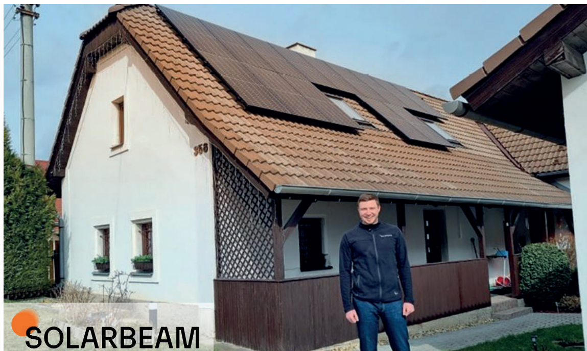
S vlastní fotovoltaickou elektrárnou si snížíte výdaje za energie. Foto: Solarbeam
