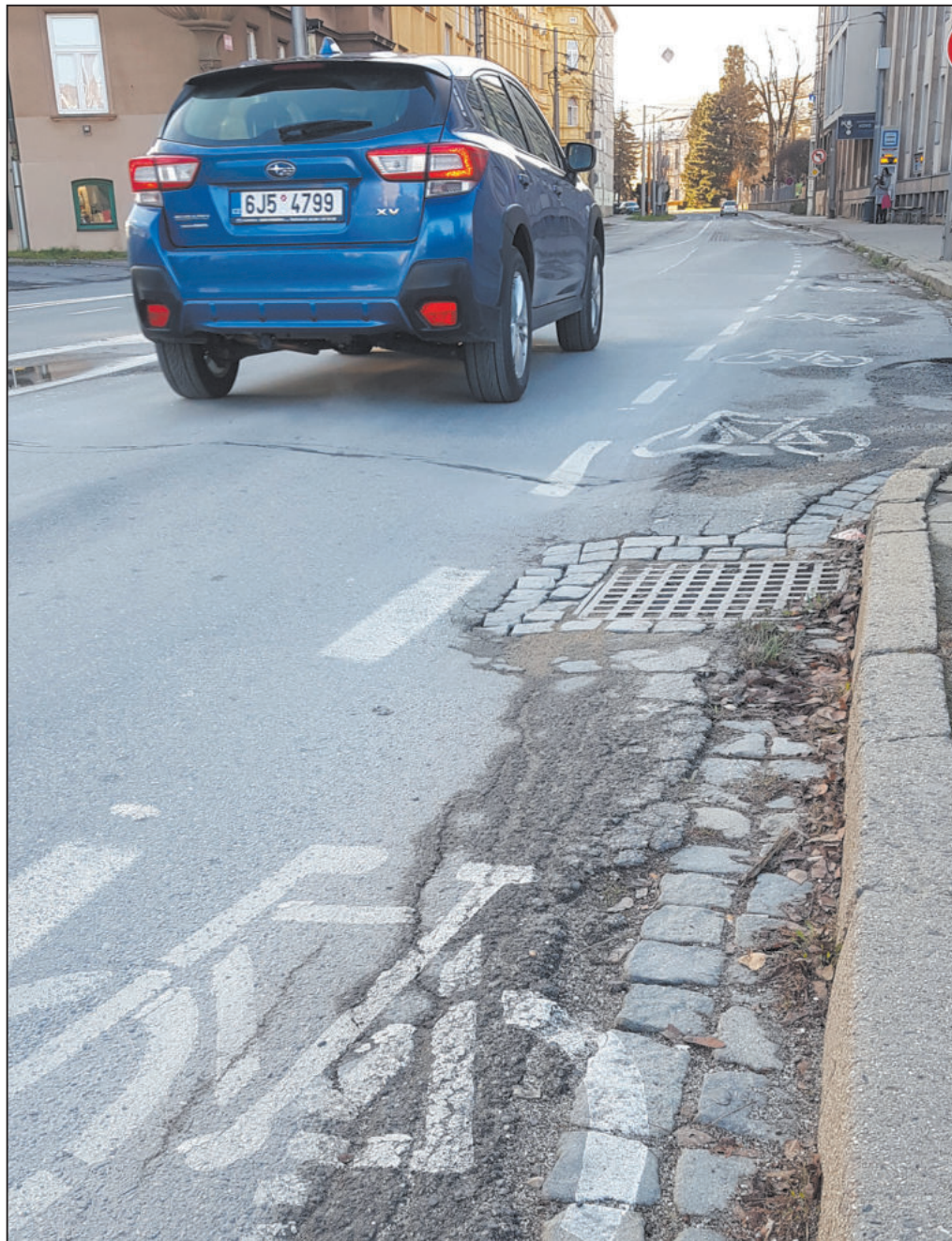
STAV vozovky v cyklopruhu například u DKO je oprávněně kritizovaný. Jízda po něm hrozí přinejmenším tím, že si natlučeme ústa. Město slibuje, že na jaře vše opraví.
