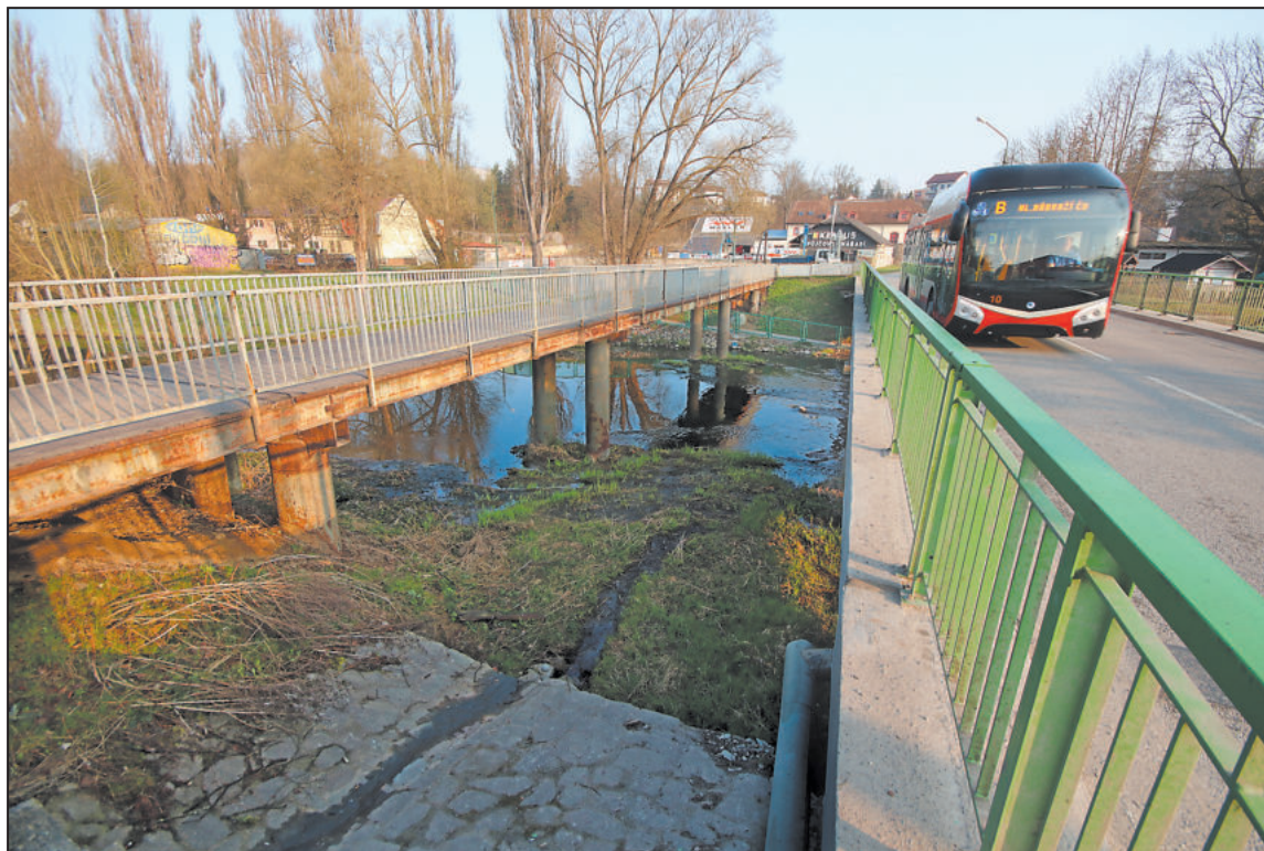
LÁVKA ve Starých Horách stojí na vlastních podpěrách v řečišti. V květnu proběhne její demolice.
