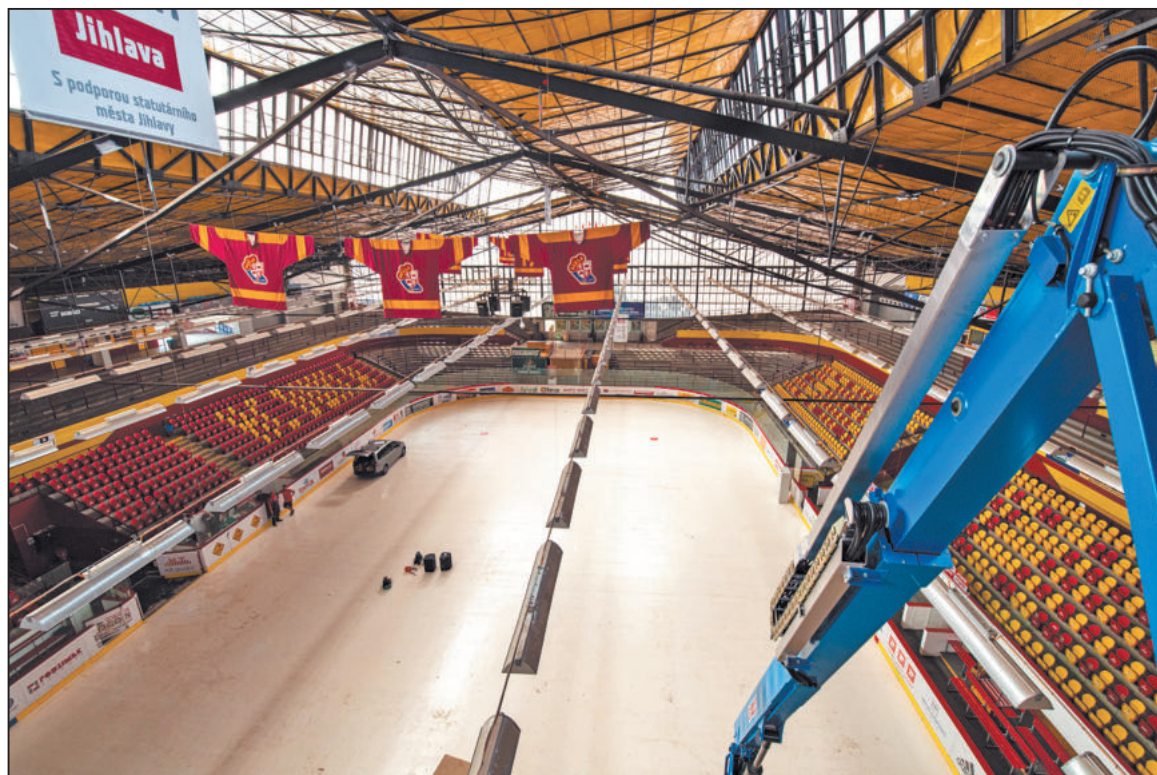
ZKONTROLOVÁNO V současné době statik vypracovává posudek, který bude odevzdán na konci srpna. Kontrolou prošla celá střecha, chlazení i ledová plocha se spoustou dalších drobností. Foto: archiv MMJ
