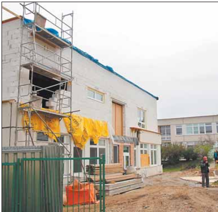
Ještě před necelým rokem se v areálu ZŠ Nad Plovárnou pohybovali především řemeslníci a těžká technika. Nyní je vybudováno nové zázemí mateřinky pro sto dětí.
