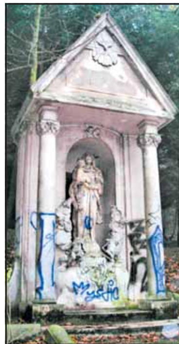
HELENÍNSKÁ kaple je ve velmi špatném stavu, proto město rozhodlo o její rekonstrukci. Foto: archiv MMJ
