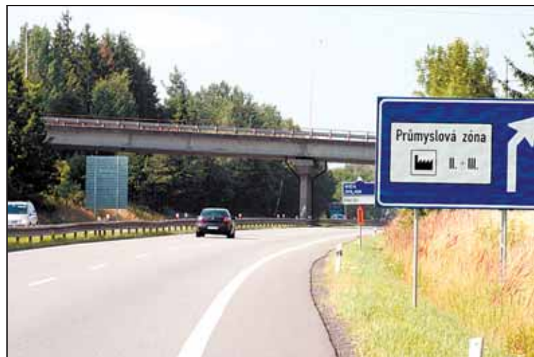
MOST ČEKÁ REKONSTRUKCE. Silniční most do Pávova, vedoucí přes dálniční přivaděč, čeká rekonstrukce. Město zatím na tento most nevyčlenilo finance, předpokládají se náklady ve výši kolem 25 milionů korun. Foto: Lubomír Maštera
