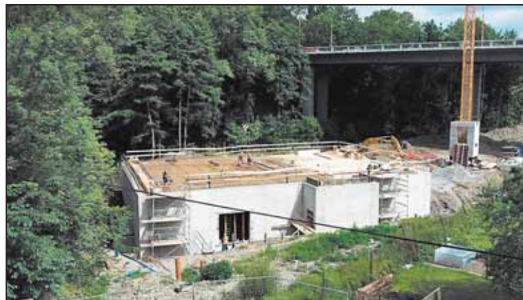
FOTOGRAFIE odkrývá pravou podobu podzemní nádrže před zakrytím zemí. Foto: archiv MMJ
